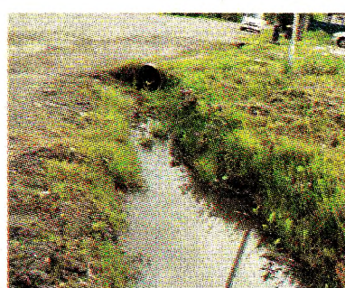
Система водоотведения на участке ул. Революционной
